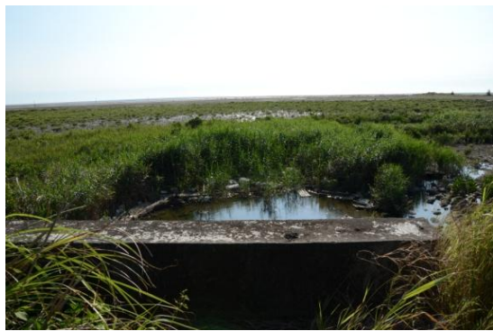
紅樹林阻礙排水口
