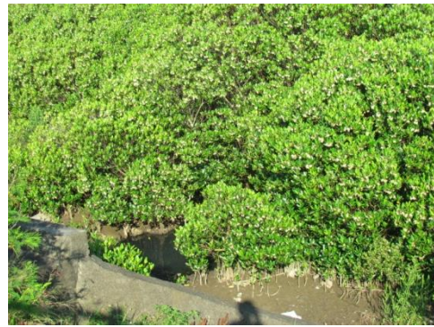
紅樹林阻礙排水口
